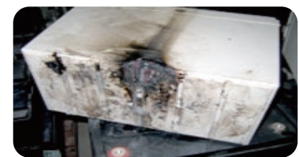
电池底部漏液
